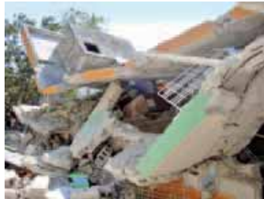
Zerstörte Schule in Port au Prince.
