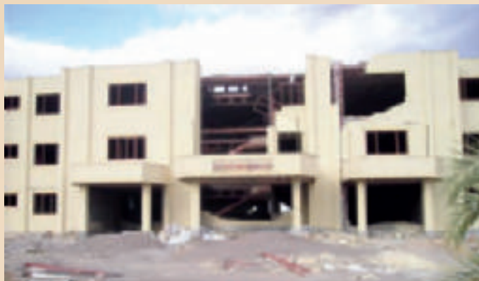
Das im Bau befindliche Waisenhaus unmittelbar nach dem Beben mit Schäden.
