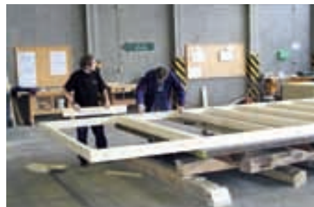
Montage eines Wandmoduls ...
