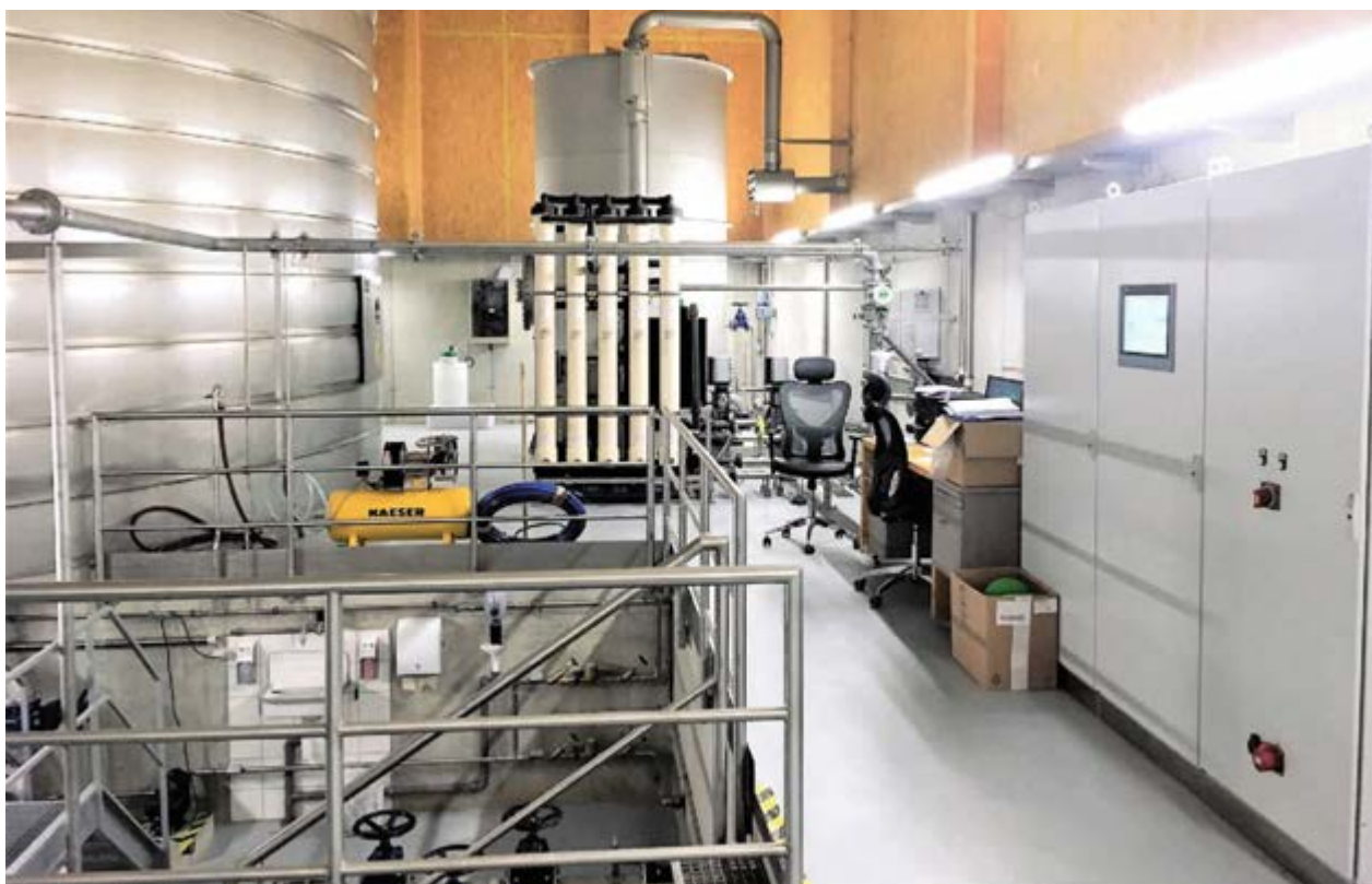
Trinkwasserversorgung in Deutschland: Hochbehälter Hohenbrach, Gemeinde Großerlach.
