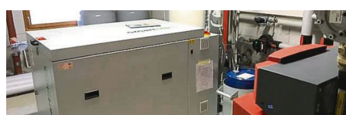
Das neue Blockheizkraftwerk in Oberpfammern.
